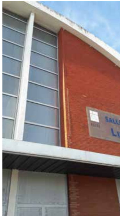
FISSURATIONS SUR LA FAÇADE EST
