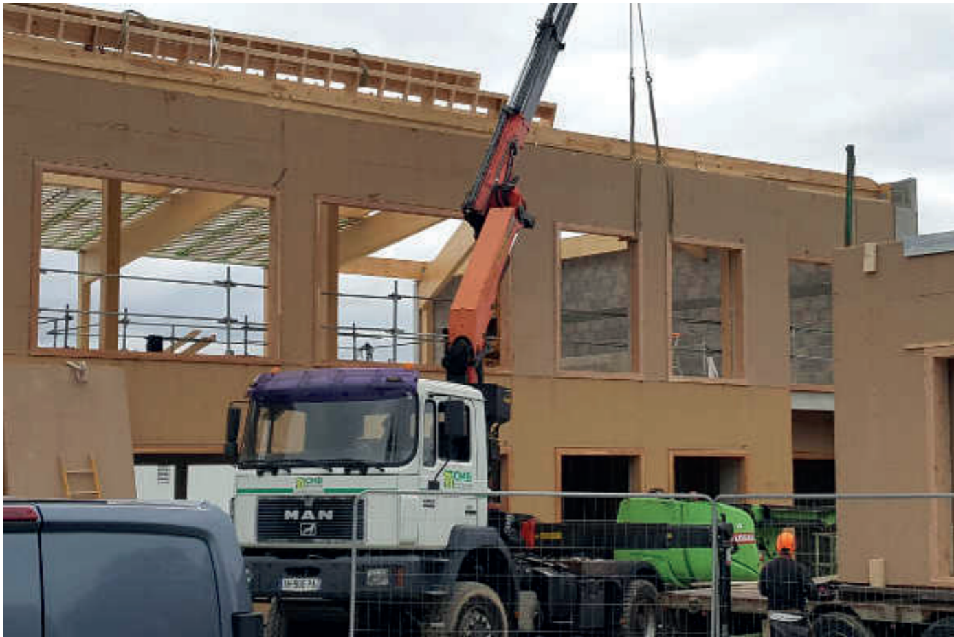
Fig.23 - Mise en place d'un panneau préfabriqué sur le chantier des bureaux à Noyal-sur-Vilaine
