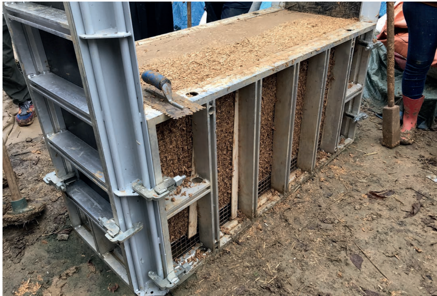
Fig.14 - Première pratique du procédé constructif CobBauge par la Fabrique Échelle 1 à l'ENSA Normandie en 2022
