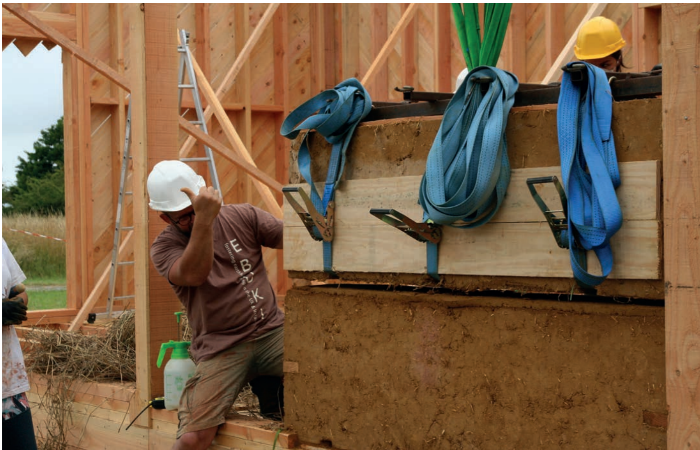
Fig.7 - Mise en place des blocs de bauge préfabriqués lors de la construction du pavillon TEPCV de la première Fabrique Échelle 1
