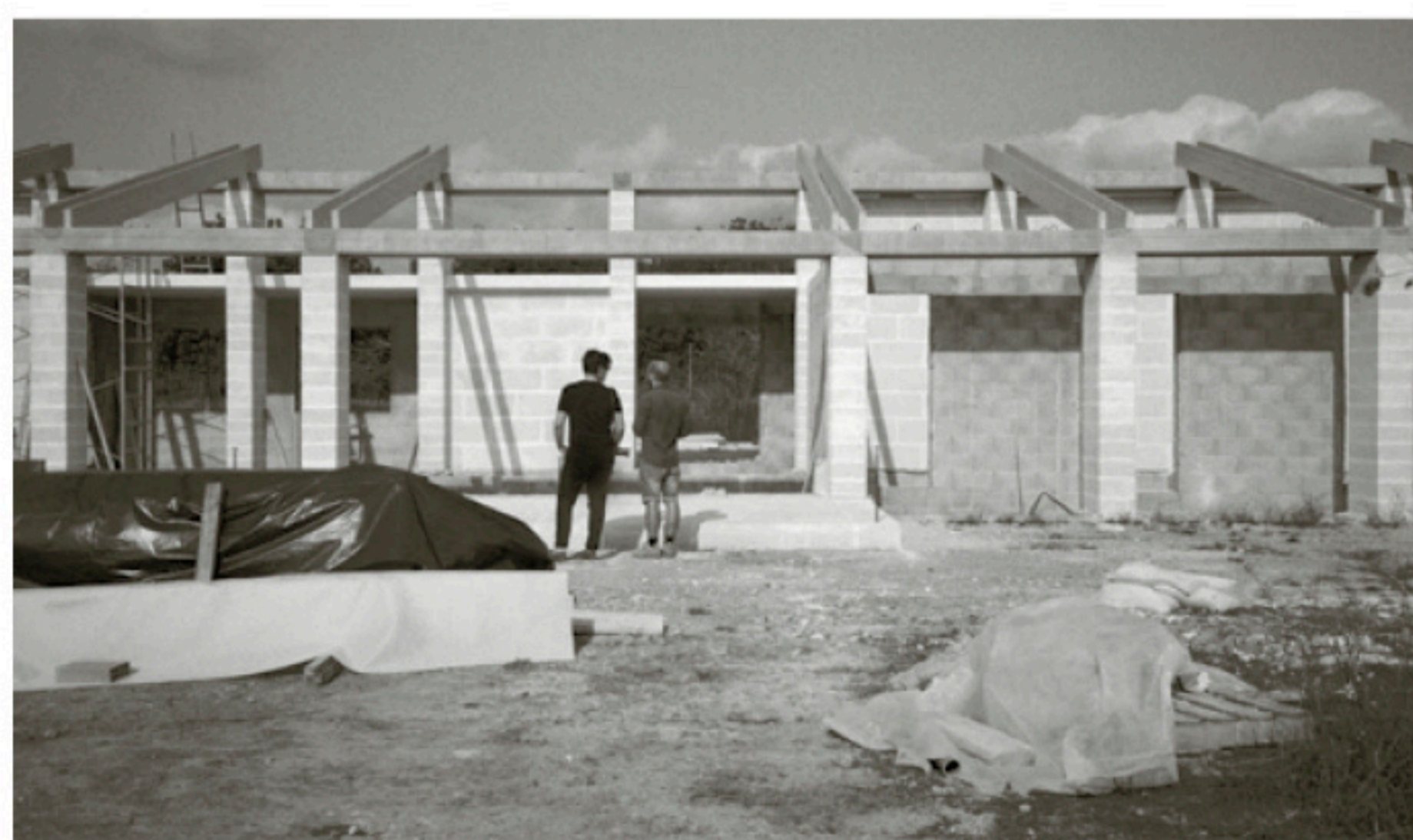
Figure 2 La maison à Campos (2023), Majorque, en chantier. Les colonnes en pierre massive comportent des renforcements intérieurs. © Natalia Petkova
